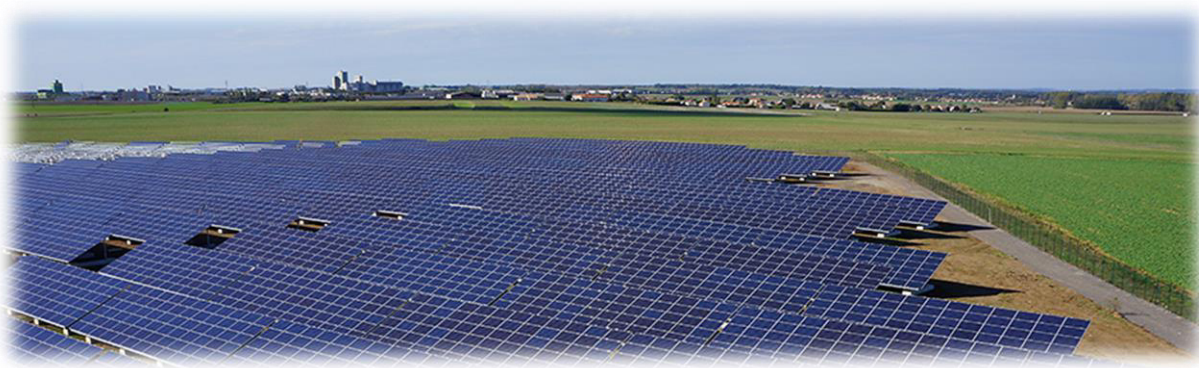
Parc solaire du projet TIPER (ex-ETAMAT) - Source : site internet CCT
